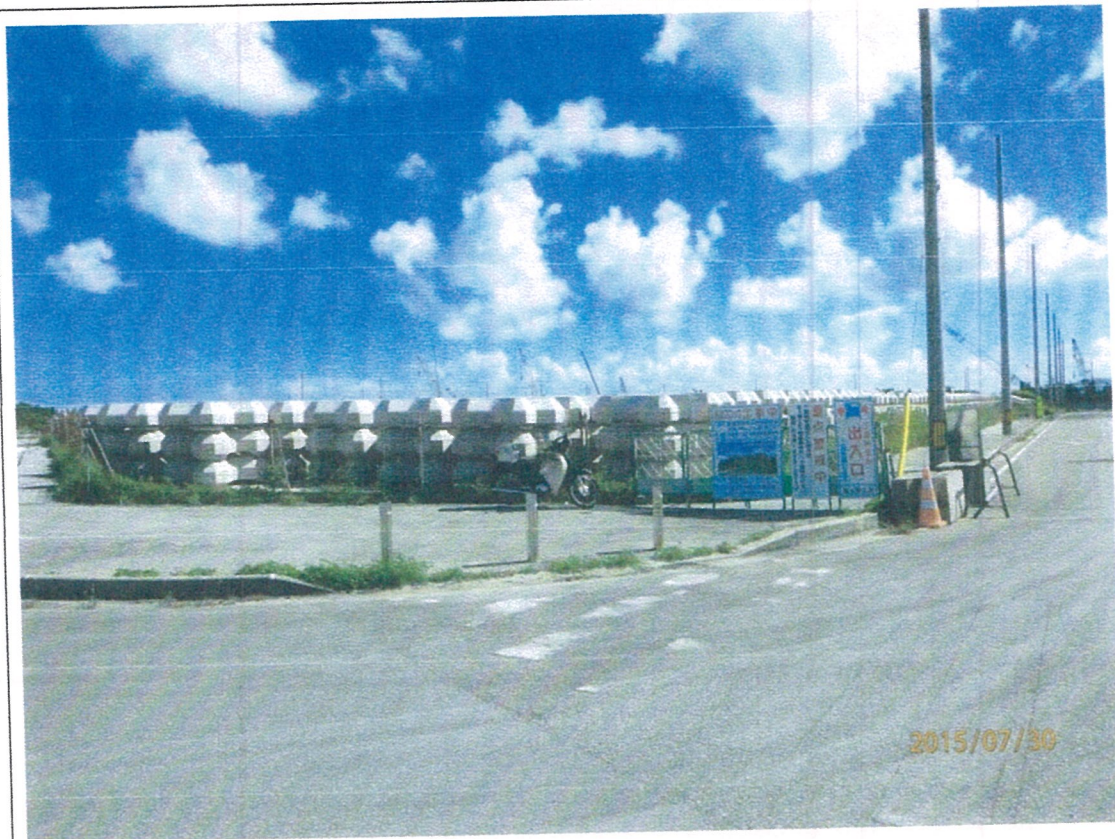
写真3. 肝高公園（写真の反対側）の北西側の工事現場とブロック
